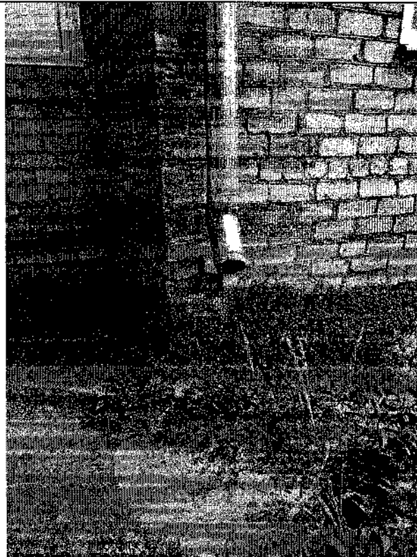
Фото 19. Водосточная труба на углу здания не доведена до уровня отмостки, отсутствует нижнее сливное колено водостока.
